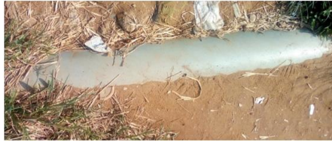
Photo 1 : Canalisation en PVC
