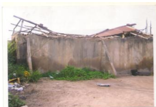
Photo 3 : Toiture décoiffée à Djidja - centre
