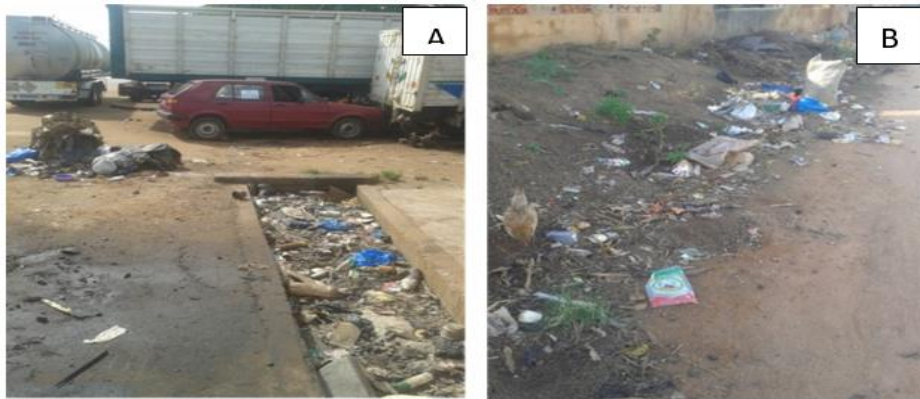
Figure 7 : Présence de déchets solides dans les caniveaux : A = Poubelle installée à proximité du collecteur (Kokrénou), B = accumulation de déchets solides dans un collecteur complètement envasé
