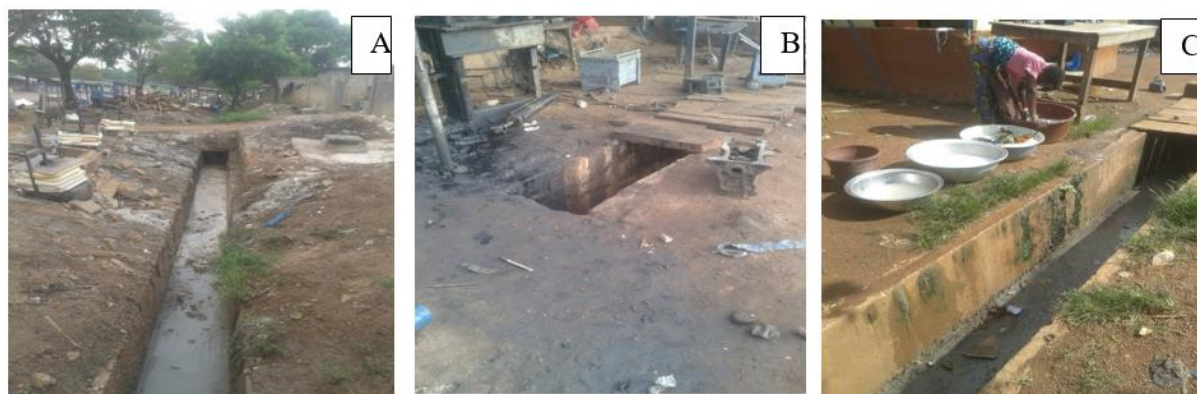
Figure 3 : Illustration des types d'eaux usées dans les canalisations d'eau pluviale : A= écoulement de jus de manioc issus de la production d'attiéké (Quartier N'Zuessy); B = Déversement d'huile de moteur dans les collecteurs (Quartier Dioulakro); C = déversement d'eau de lessive (Quartier Kokrénou)
