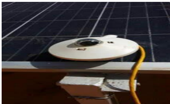
Figure 5 : Solarimètre utilisé pour mesurer l'ensoleillement sur le site d'étude
