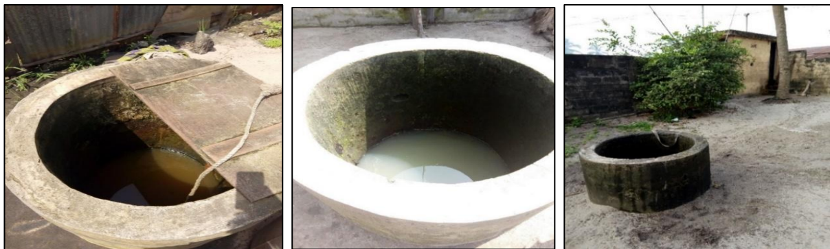
Figure 2 : Photo indiquant l'état des puits dans l'arrondissement de Ekpè
