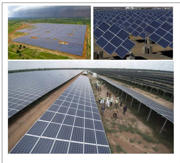
Figure 1 : Centrale PV de Zagtouli
