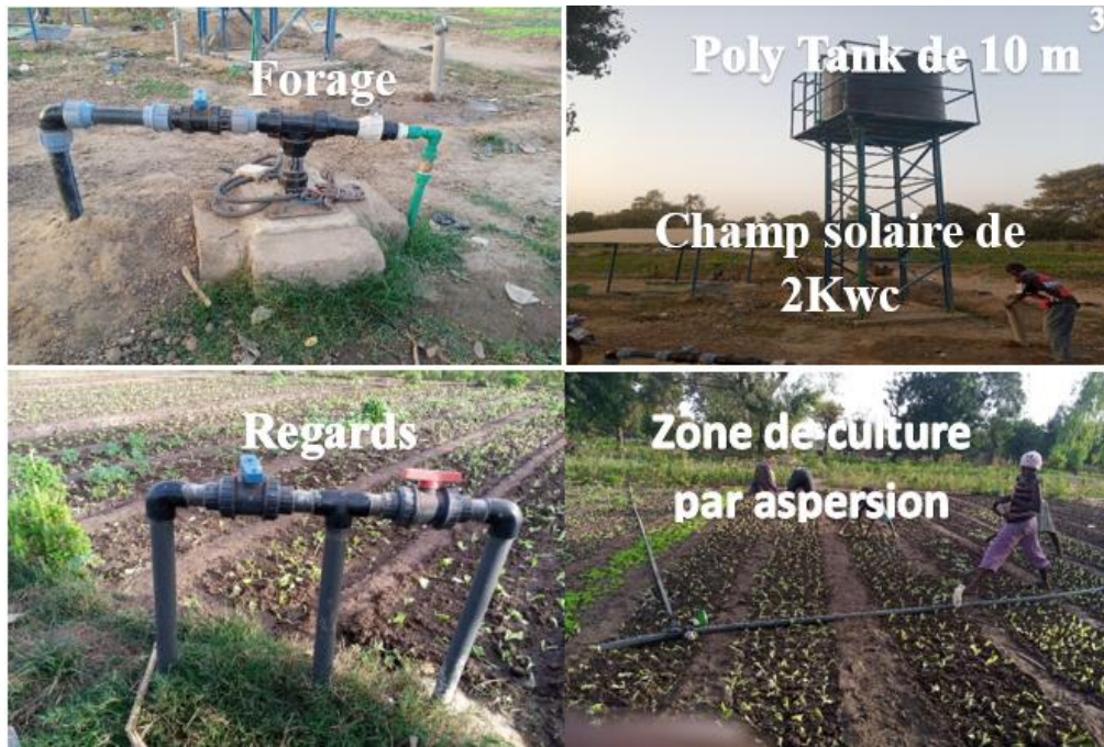
Figure 6 : Irrigation par système de pompage solaire Photovoltaïque
