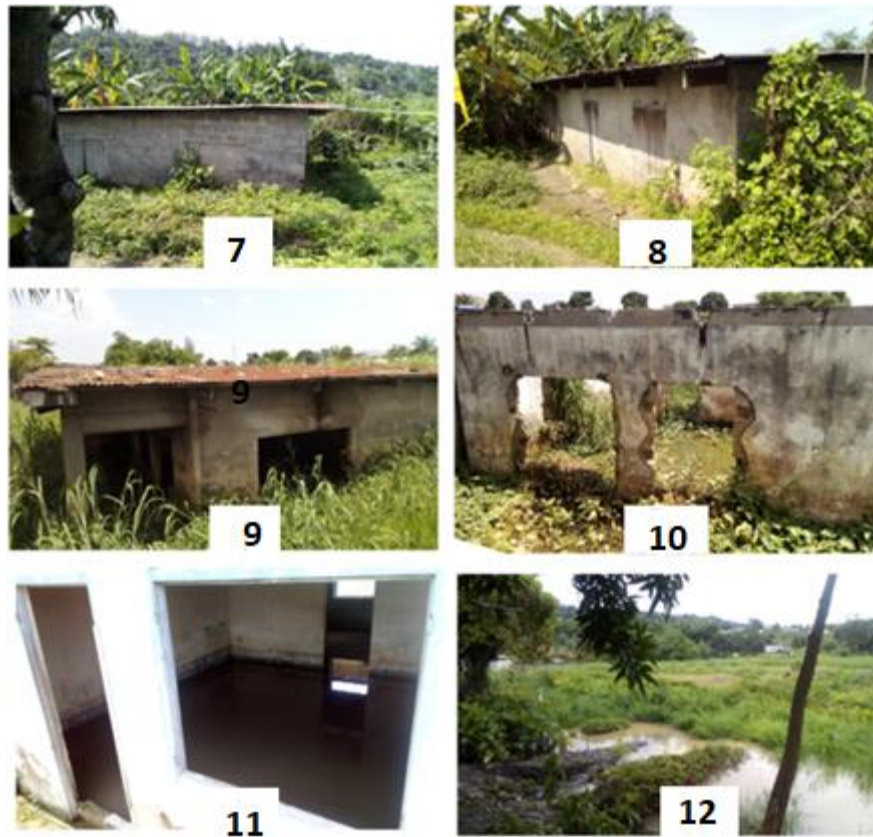
Figure 4 : Images relatives aux conséquences des inondations a Mikalou Madzouna (P 7,8 ) : maisons abandonnées par les populations suites aux inondations, (P 9,11 ) : maisons abandonnées avec extractions des tôles et des ouvertures, (P 12 ) : destruction d'un maraîchage dans la vallée de la Tsiémé. © Sitou et Etoua Douniama, 2021
